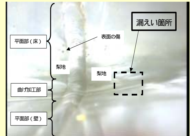
曲げ加工部の例（漏えい箇所）
